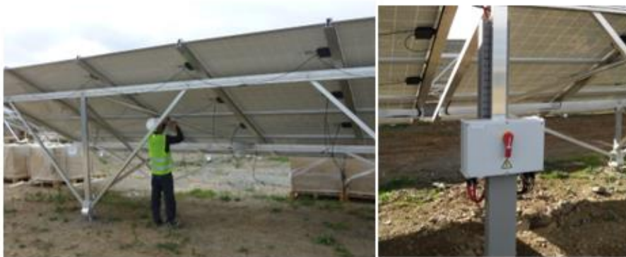
Figure 15: A gauche : Câblage des panneaux - A droite ; Boîtier de raccordement - Q ENERY France
